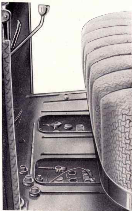
Fig. 27. — Vue montrant la facilité d'accès aux accumulateurs. On aperçoit sur le plancher les 3 bouchons démontés pour vérifier le niveau de l'électrolyte.
